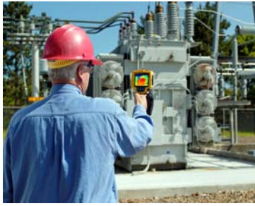
Revisión del cuerpo de un transformador y sus sistemas de ventilación
